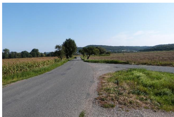
Obr. 22.: Místo možného přelévání komunikace Březina-Hradčany
