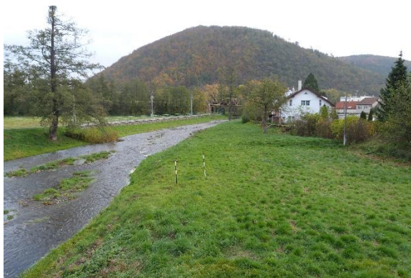
Obr. 23.: Úsek toku Loučky s nedostačující pravobřežní ochrannou hrází
