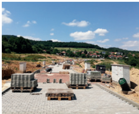
Technická infrastruktura v lokalitě Pod Horkou.
